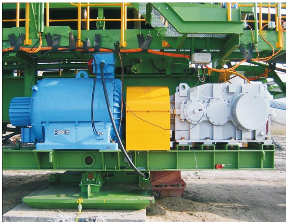
Fot. 1. Układ napędowy głównego taśmociągu węgla z przekładnią BH 500 produkcji BEFARED
